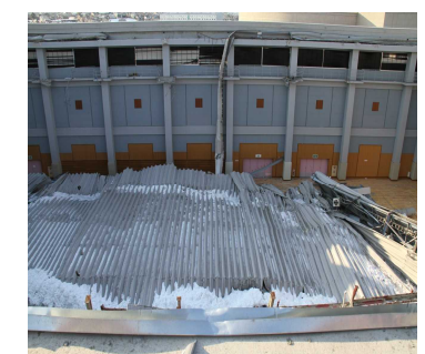
体育館の屋根崩落被害(埼玉県)
