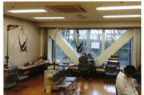
既存部分への影響の少ないピロティ部分の増築(リハビリ室)とあわせたブレース設置
